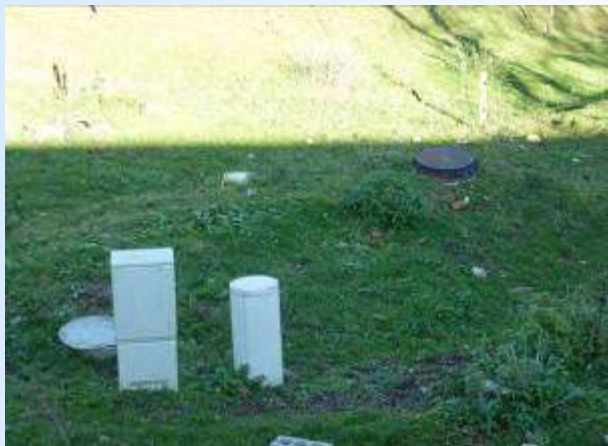
Slika 23: Mala čistilna naprava Novi Pot
