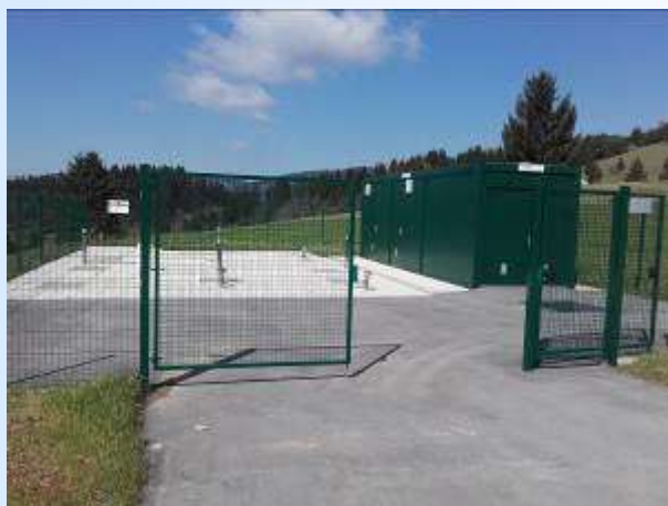
Slika 24: Čistilna naprava Mali Log
