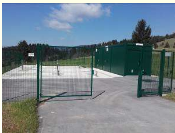
Slika 36: Mala čistilna naprava Mali Log
