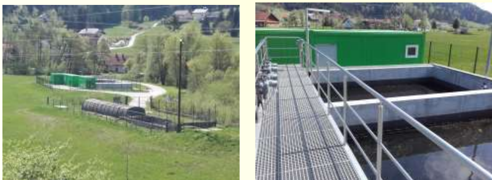
Slika 33: Mala čistilna naprava Sodražica
