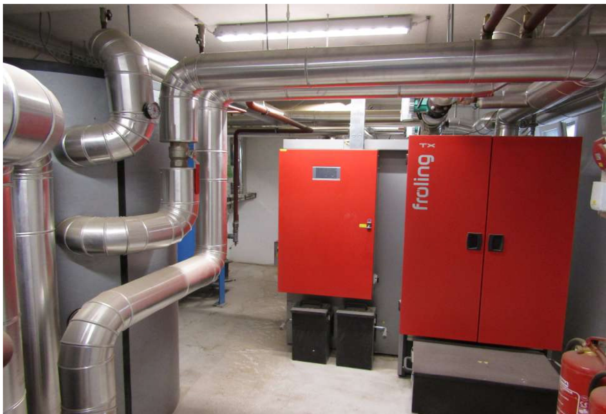
Nova kotlovnica v Sodražici, oktober 2018.
