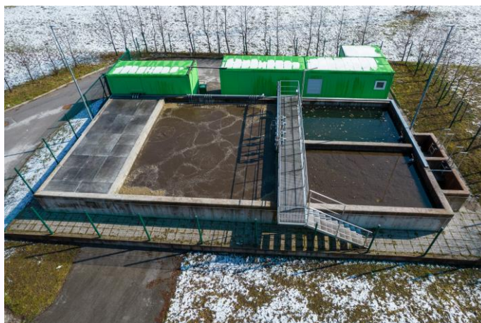
Slika 20: Čistilna naprava Sodražica
