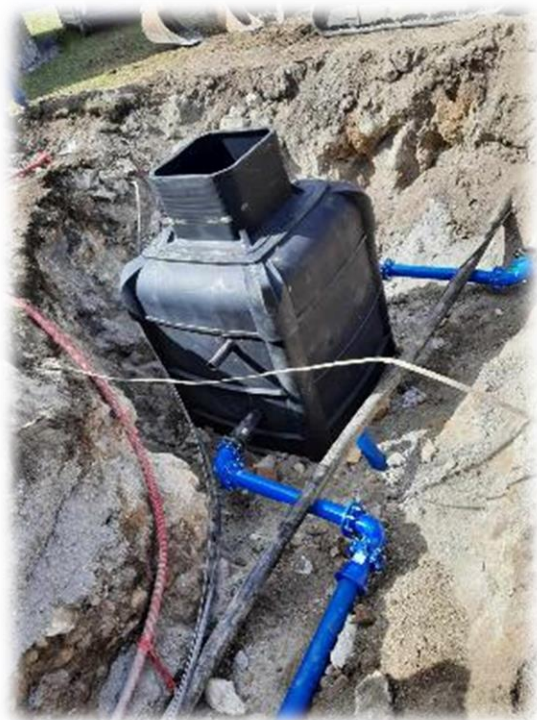
Merilni jašek v Dolu
