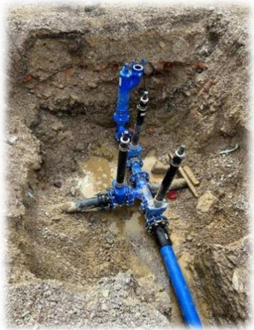
Nov talni hidrant, odcep in vodovod v naselju Mlaka
