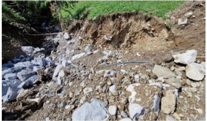
Poplave Ljubno 2023: poškodovana cev vodovoda
