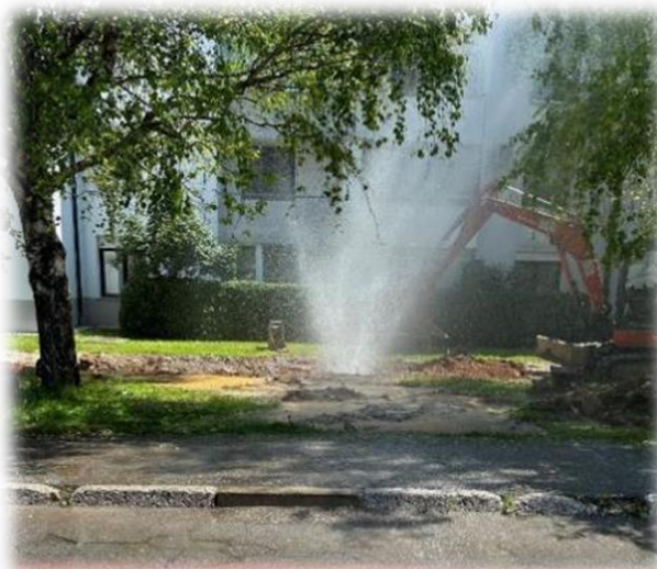
Puščanje cevi med izvajanjem obnove
